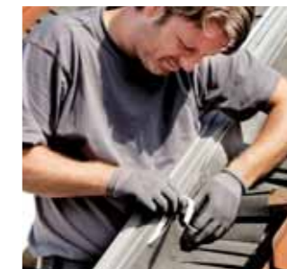
3. Fensterstock ist eingesetzt Nachdem das neue Fenster eingesetzt wurde, wird dieses mittels der Unterdachschürze fachgerecht und wettersicher ins Unterdach eingebunden.
